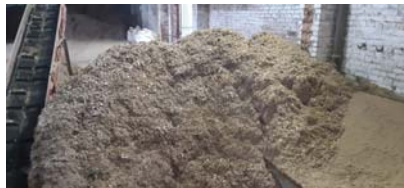
Рисунок 1. – Топливный склад котельной
