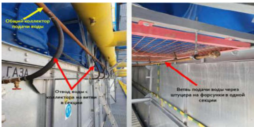
Рис. 4. Монтаж воды с общего коллектора на ветви с форсунками в секциях
